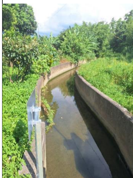
關注棲地：導水路兩側水泥垂直護岸，應使用金屬擴張網設置坡道以利動物逃脫
