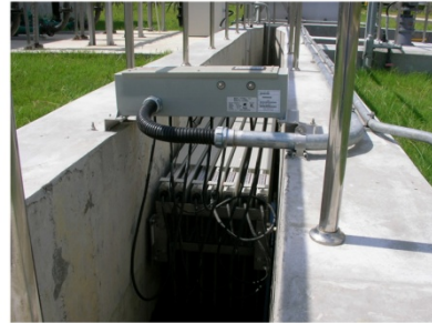
(d) 渠道式紫外線消毒設備
