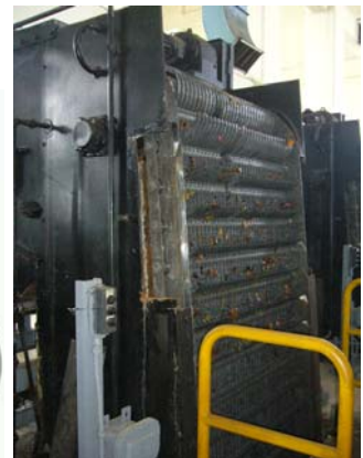
c. 高雄中區污水處理廠照片
