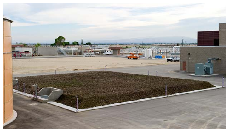
圖 2-58 除臭用生物濾床照片
