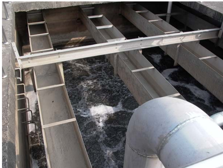
圖 4-35 好氧生物濾床系統(台南市虎尾寮污水處理廠)
