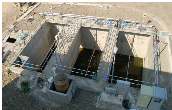
圖 7-21 好氧消化槽 (大溪污水處理廠例)
