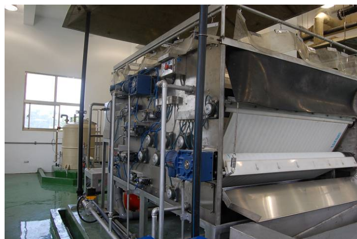
圖 7-23 帶壓式脫水機（林口南區污水處理廠例）
