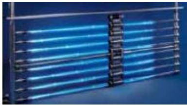
(e) 水平渠道式紫外線消毒設備
