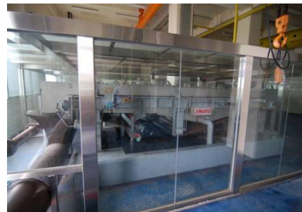
帶濾式濃縮機外圍設置玻璃防臭罩照片 (宜蘭地區水資源回收中心例)
