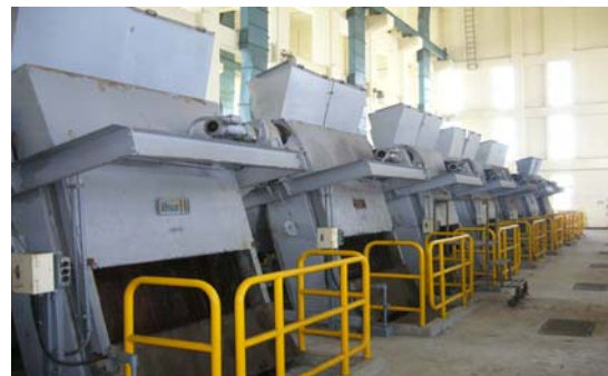
c. 高雄中區污水處理廠照片
