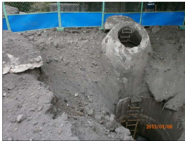
圖 1-32 國內某污水下水道人孔內瓦斯氣爆案例
