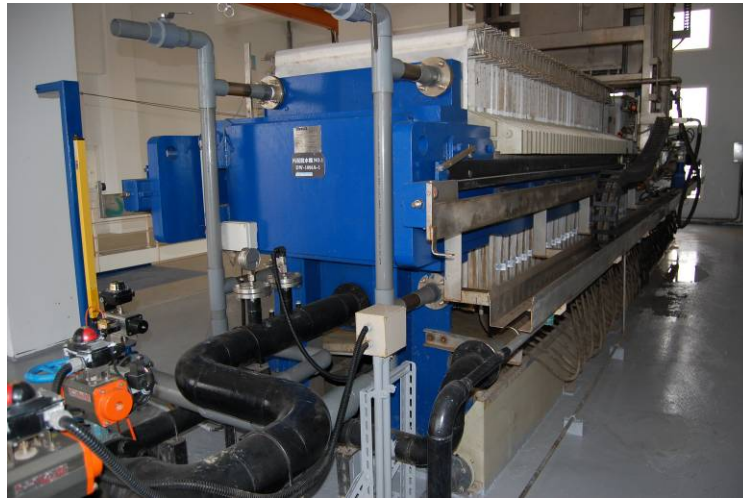
圖 7-27 壓濾式脫水機(淡水水資源回收中心例)
