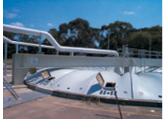
圖 3-110 圓形初級沉澱池加防臭蓋 (澳洲 Subiaco 污水處理廠)
