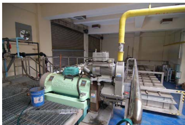
圖 7-25 離心式脫水機例（宜蘭水資源回收中心）
