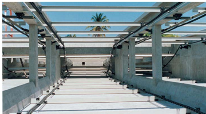
圖 3-132 長方形沉澱池池間採開孔隔牆
