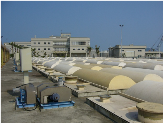
圖 3-109 初級沉澱池的防臭蓋 (基隆和平島污水處理廠)
